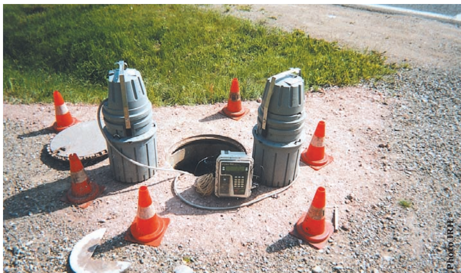
Préleveur automatique d'eaux usées pour le contrôle des rejets.
