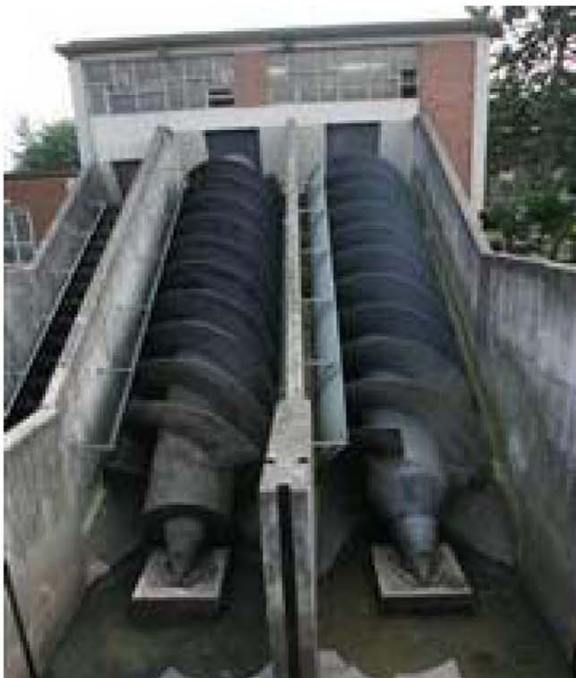
Le réseau d'assainissement est un maillon primordial du cycle de l'eau. le public est invité à mieux le connaître, grâce à une exposition.
